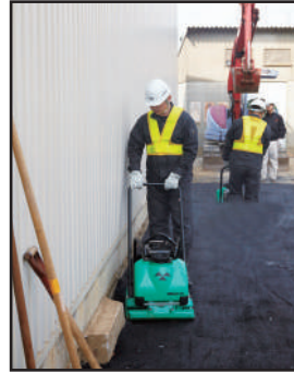
Con las adecuadas fuerzas de compactación para realizar una óptima compactación del asfalto.
